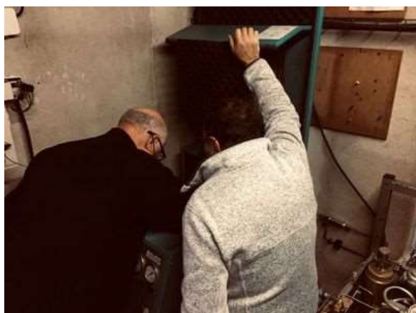
Compresseur livré et installé
